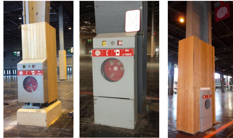
RIA ROBINET D'INCENDIE ARMÉ
