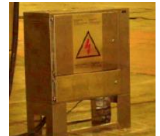
COFFRET DE CHANTIER
